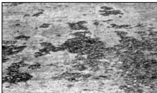
Descascamiento de las superficies de concreto
